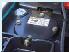
Serbatoio dell'olio idraulico
