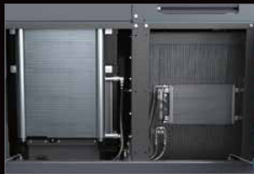
Sistema de refrigeración
